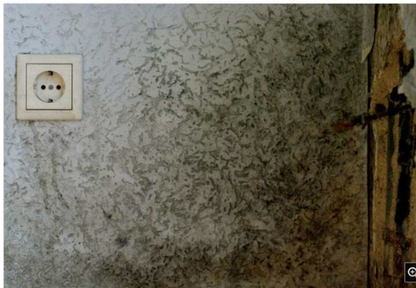
Ungeliebte Untermieter: Schimmelpilze gedeihen vor allem bei Feuchtigkeit
